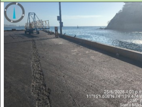
Fotografía 27. Borde de seguridad – Muelle 7
