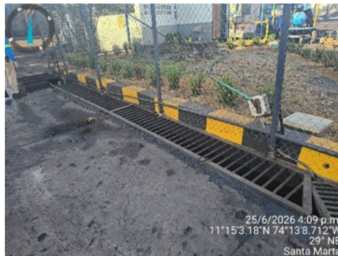
Fotografía 25. Sistema de captación de aguas
